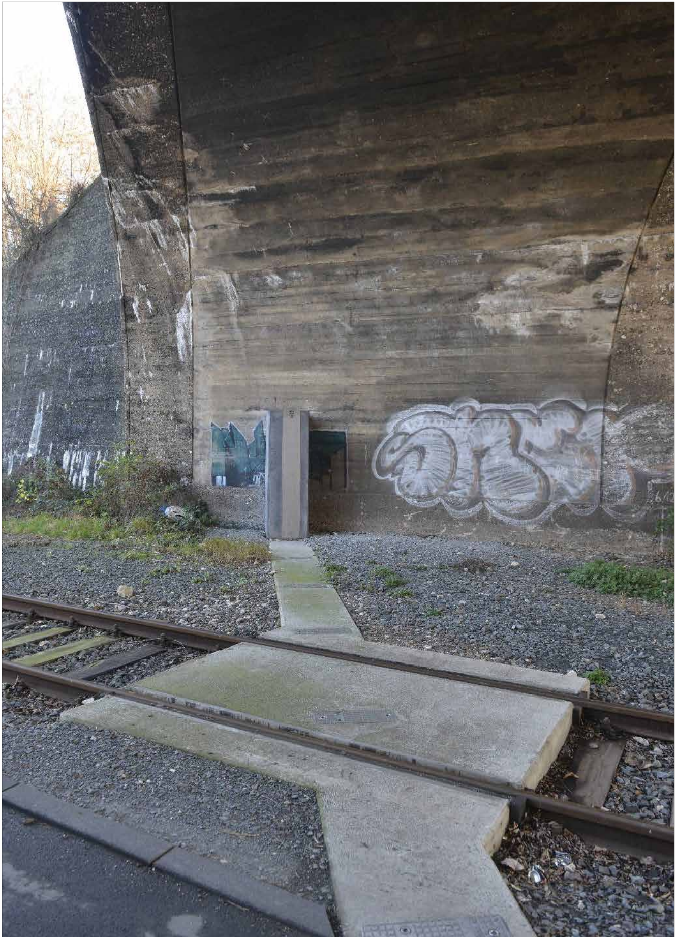
Abb. 15 Hochwasserschutzvorrichtung im Bahndamm
